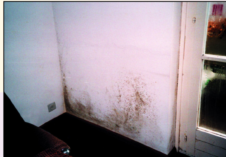
Mit Schimmelpilz befallene Wand in einer Wohnung Foto: A. Schwarz
